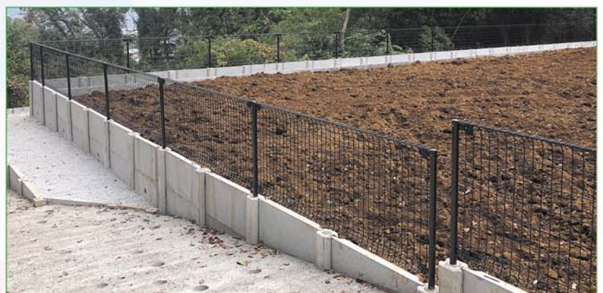
ウェブサイトにて土留め施工例を多数掲載しています
