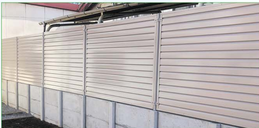
頑丈な土留めにする場合は1スパンを1メートルにして下さい
